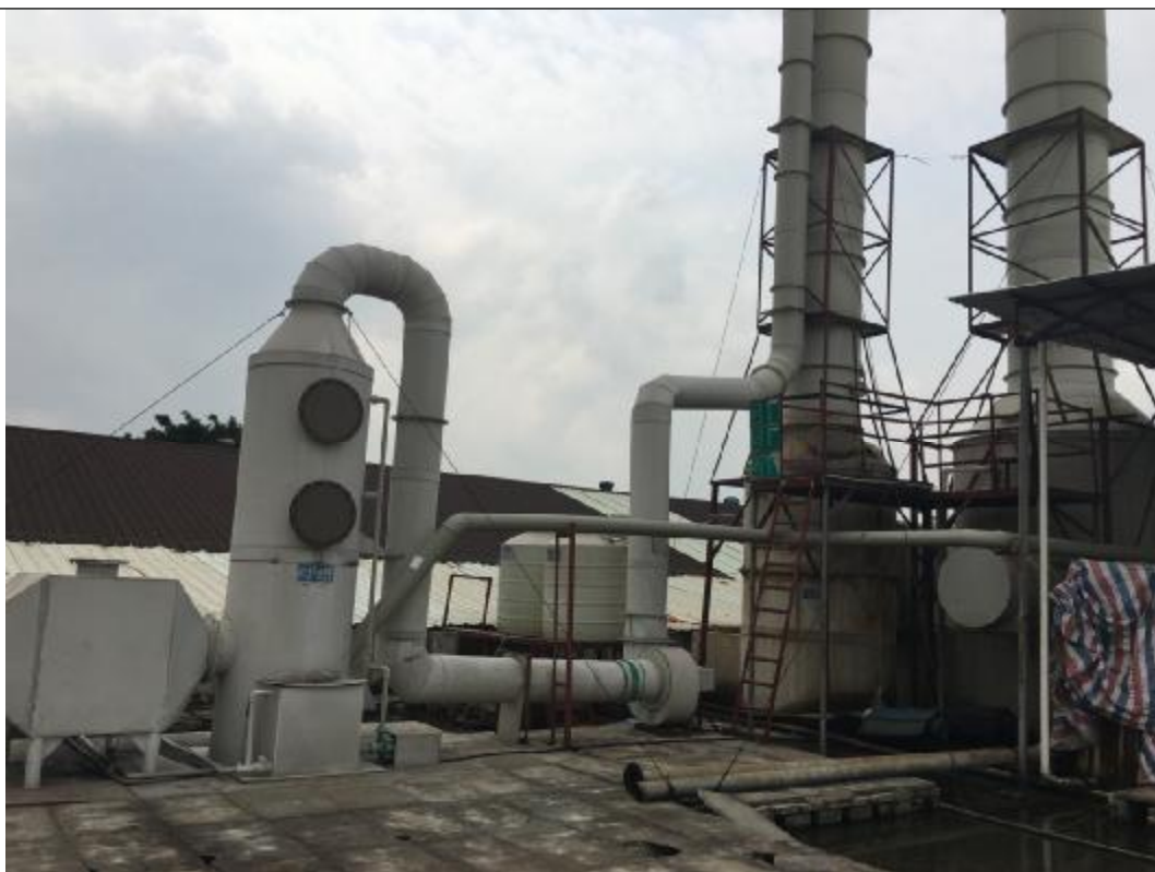
有机废气治理系统
