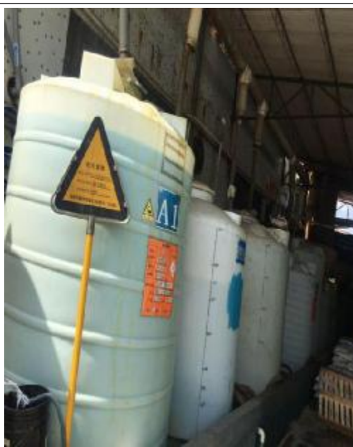
废液储罐（设置围堰）
